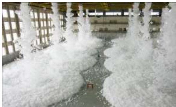
Рисунок 4 - Спринклерная установка пожаротушения
