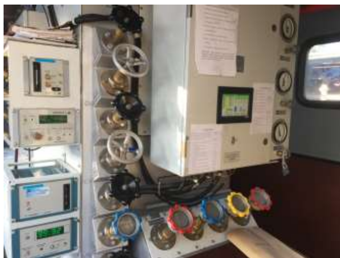
Рисунок 1 – Щит управления блока разделения воздуха
