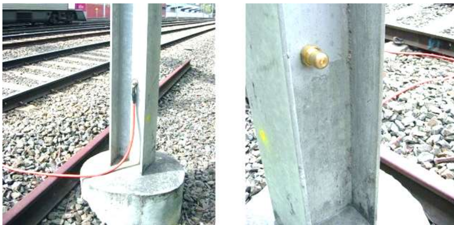
Рисунок 2 – Заземление опор контактной сети
