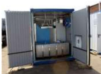
Рисунок 2 – Азотный мембранный генератор в контейнере
