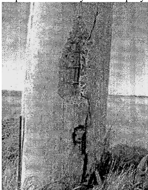
Рисунок. 1 Дефектная железобетонная стойка
