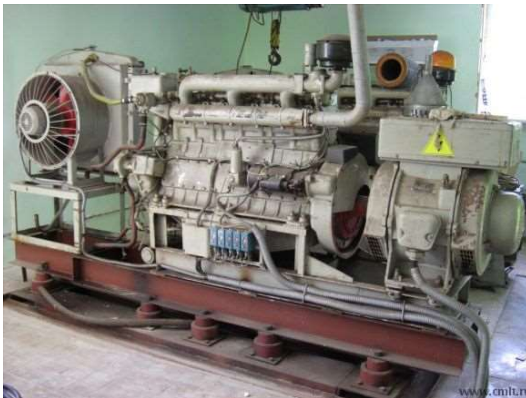
Рисунок 1 - Автоматизированная дизель-генераторная установка
